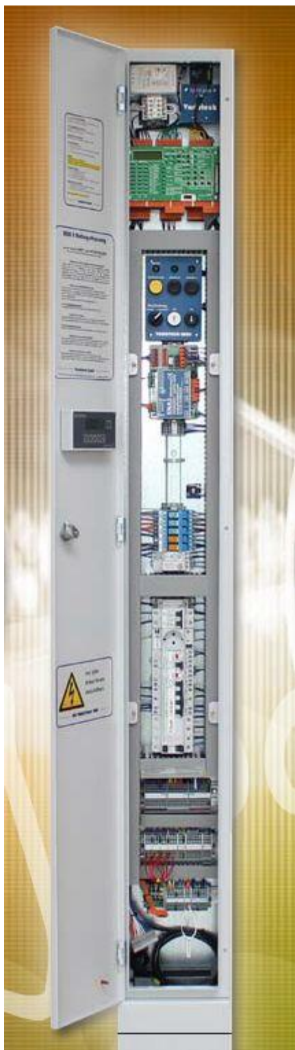
Detail rozvodnej skrine s rozvádzačom
